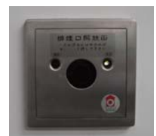
排煙口開放函
