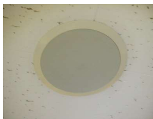
非常放送(室内スピーカー)
