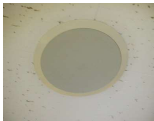
非常放送(室内スピーカー)
