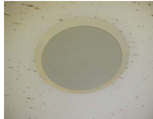
非常放送(室内スピーカー)
