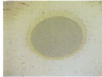
非常放送(室内スピーカー)
