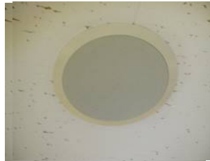
非常放送(室内スピーカー)
